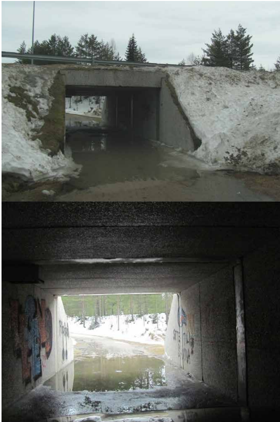
Kuva 52. Taivalvaaran alikulkukäytävässä on pahoja kuivatus- ja valaistusongelmia.
