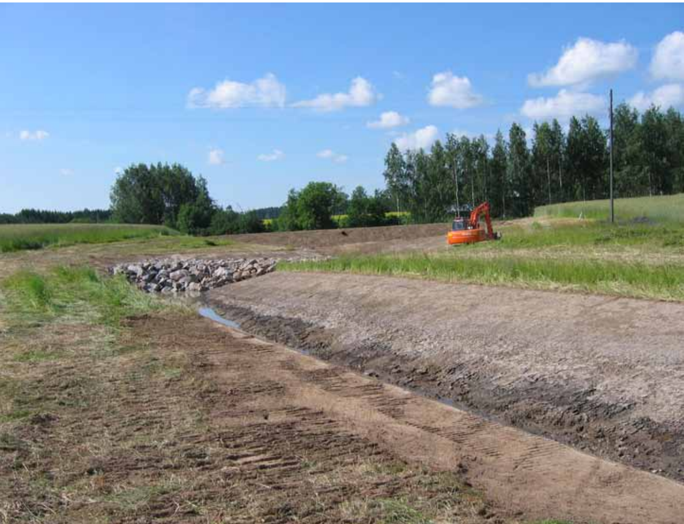
Kosteikko voidaan tehdä patoamalla oja. Työ on hyvä tehdä mahdollisimman kuivana aikana. Taustalla toisessa padossa näkyy ylivuotoputki, joka voi olla tarpeellinen, jos arvioidaan, että vesi muuten menee padon yli ja rikkoo rakenteita. Kuva: Anni Karhunen
