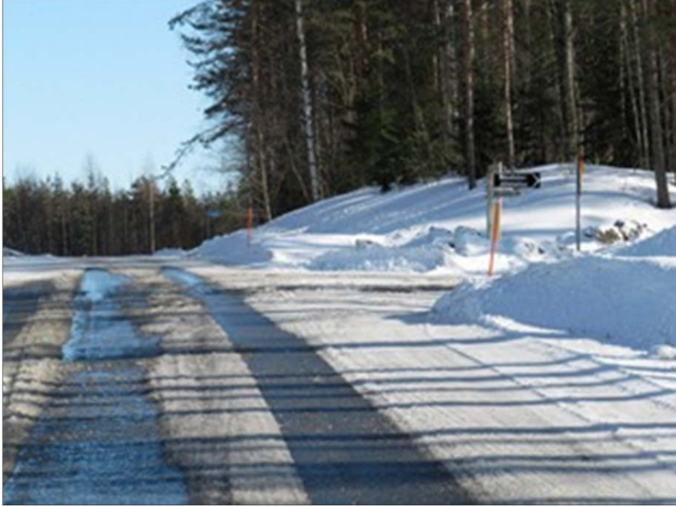
Kuva 5-3. Nousialan jäteaseman hankala liittymä Moinsalmen maantiellä 15197. Liittymästä on lyhyt näkemä itään mäkkikumpareen ja maantien mutkan vuoksi. Liittymäpaikka pitäisi parantaa. Ensivakuksi esitetään nopeusrajoituksen alentamista 80 km/h:sta 50 tai 60 km/h:ksi. Kuvälähde: Savonlinnan Seudun Jätehuolto Oy.
