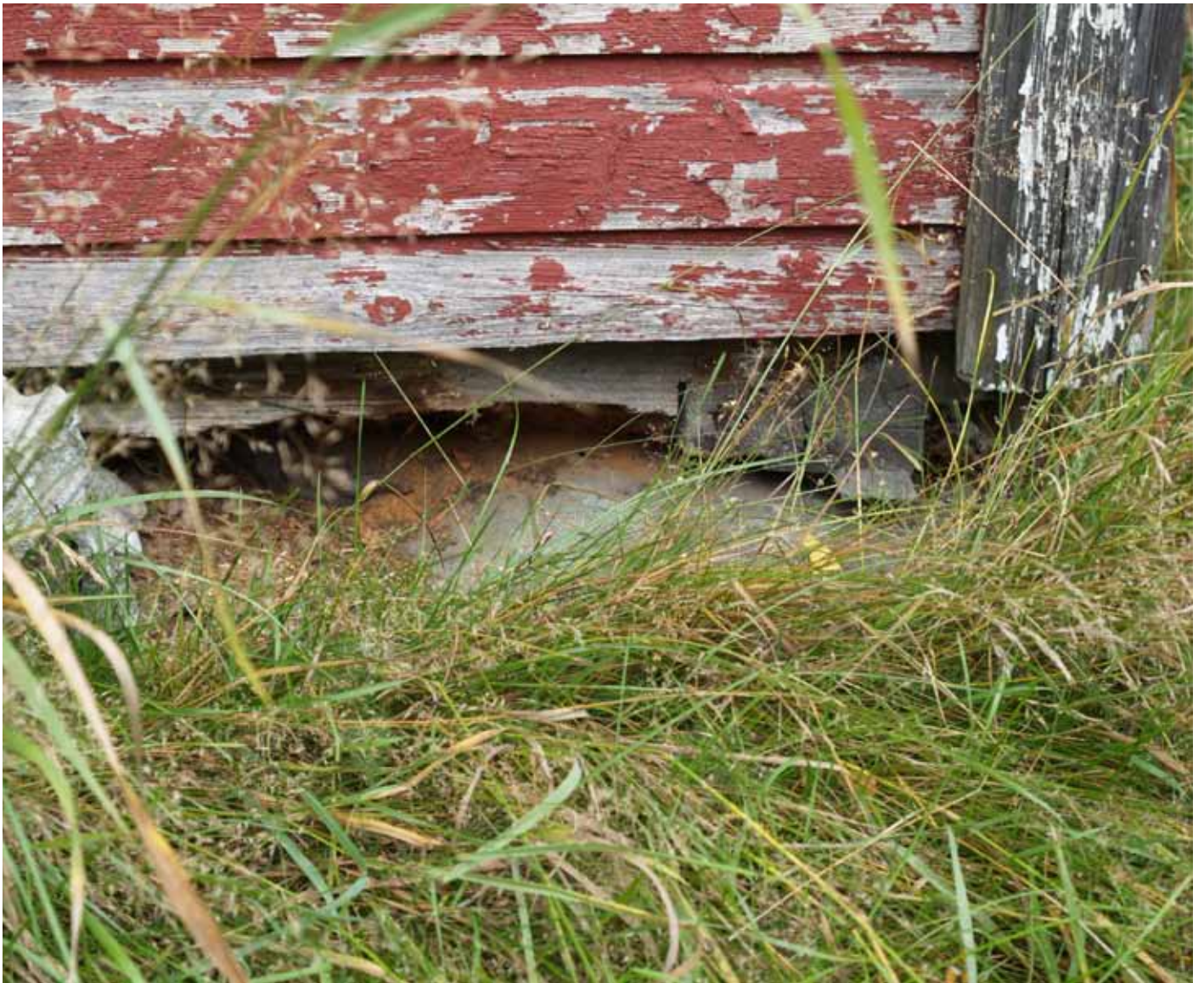
Rakennuksen eteläpäädynnurkka. Huomioi kuinka kasvillisuus on voinut estää rakenteen vioittumisen havaitsemista.
