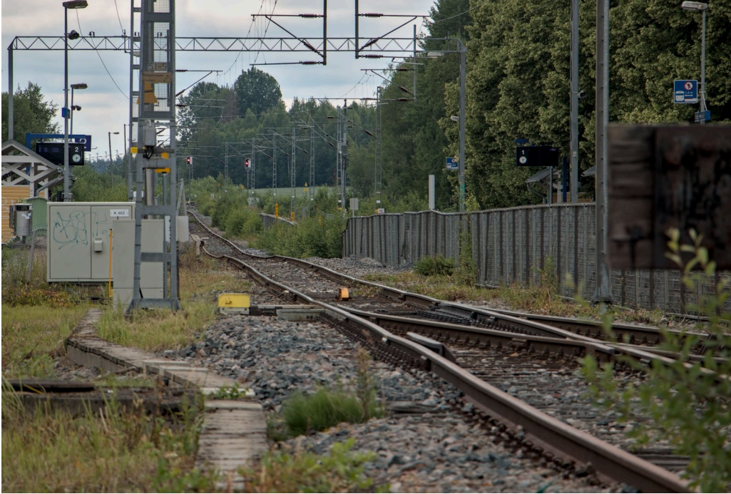
Kuva 9. Siuntion liikennepaikalla radan geometriassa ja rakenteessa on pahoja ongelmakohtia.
