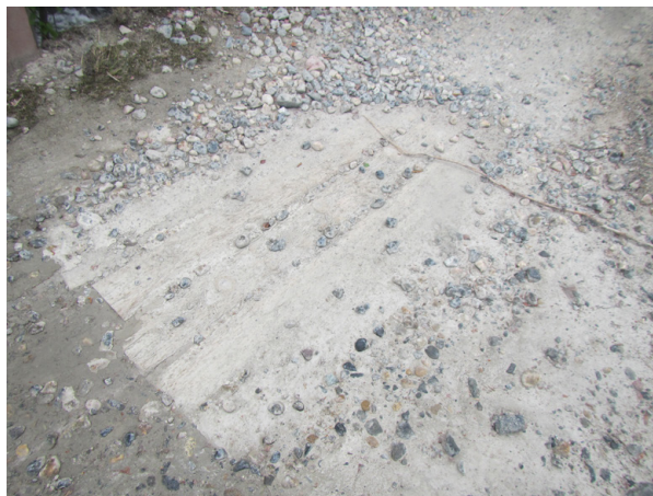
Kuva 64., Sillan huonokuntoinen puukansi.
