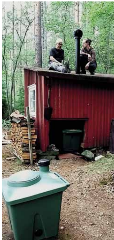
Artikelförfattaren Petri Huovila och sonen Joel installerar en Green Toilet 120-dubbelversion som gjorde torrtoaletten på sommarstugan helt luktfri.
