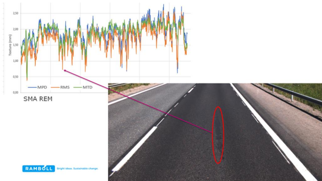
Kuva 34. SMA/REM, tie 45, sideaineen pintaan nousu.
