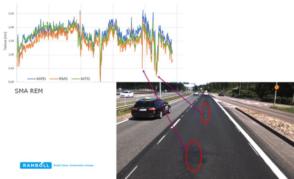
Kuva 33. SMA/REM, tie 45, sideaineen pintaan nousu.
