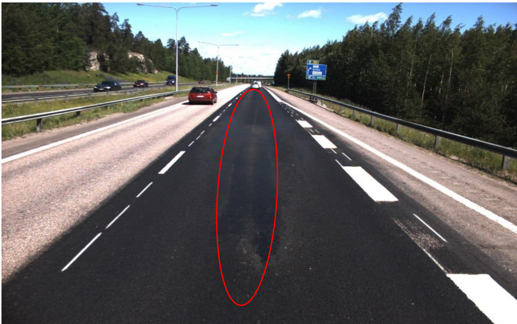
Kuva 10. Sideaineen pintaan nousu ajokaistan keskellä tiellä 45, SMA/REM.
