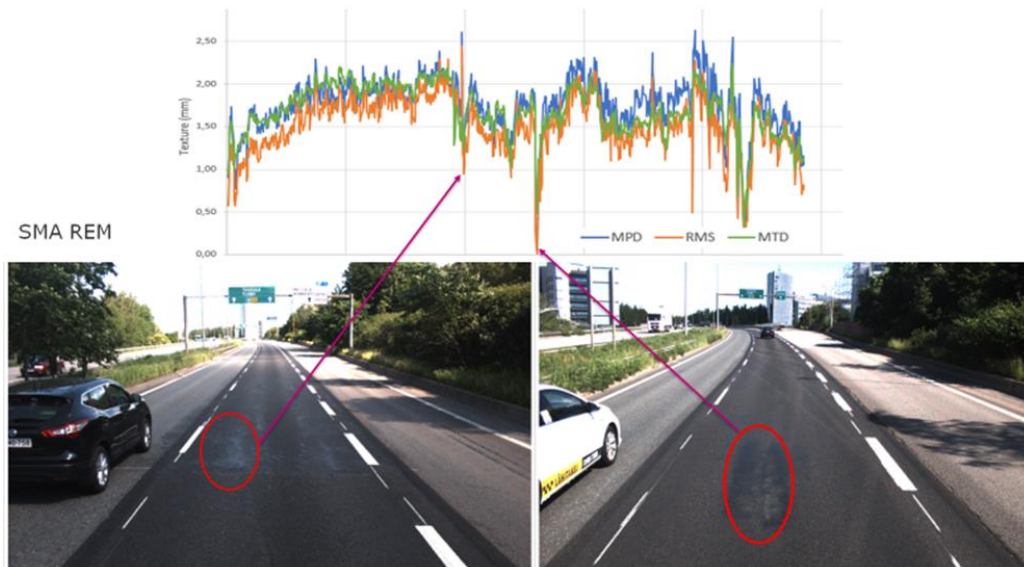
Kuva 32. SMA/REM, tie 45, sideaineen pintaan nousu.
