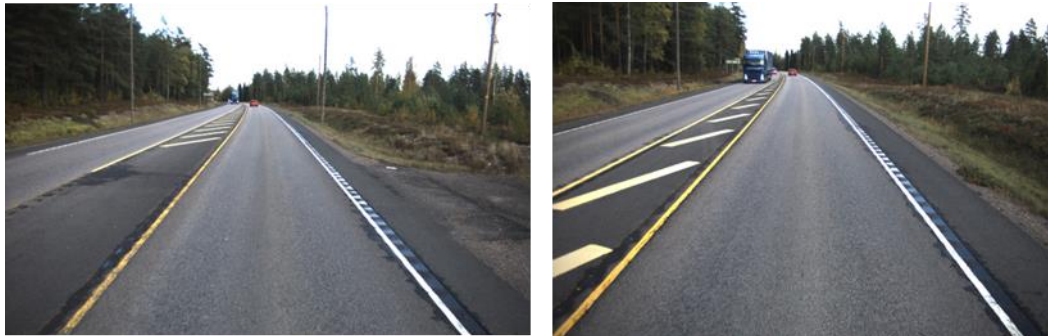
Kuva 35. Vt 25/30/ 1700 – 1800 lievä painuma yksityistieliittymän jälkeen.
