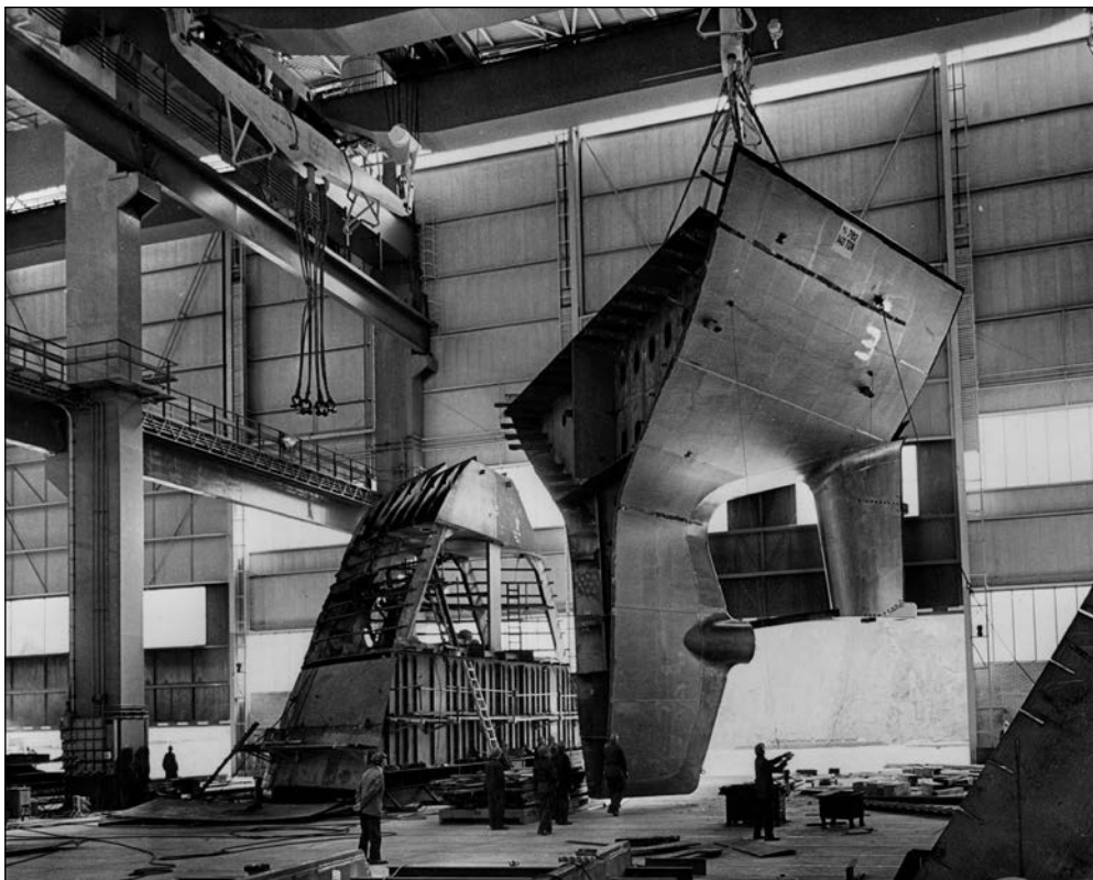
En sektion håller på att lyftas på Arendals skrovhall. Bild: Sjöfartsmuseet Akvariet i Göteborg
