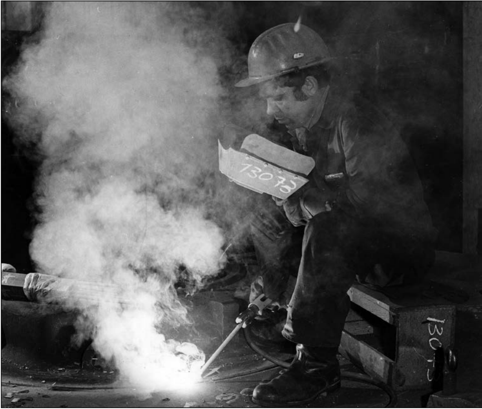
En svetsare i sitt arbete på Eriksberg på 70-talet. Bild: Varvshistoriska föreningen i Göteborg
