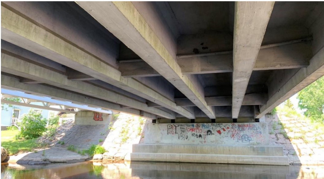
Kuva 30. Sillan kannen alla on töherryksiä. Kuvassa näkyvät myös 1994 korjauksen yhteydessä lisätyt poikkipalkit. Kuva Juha Jalonen.
