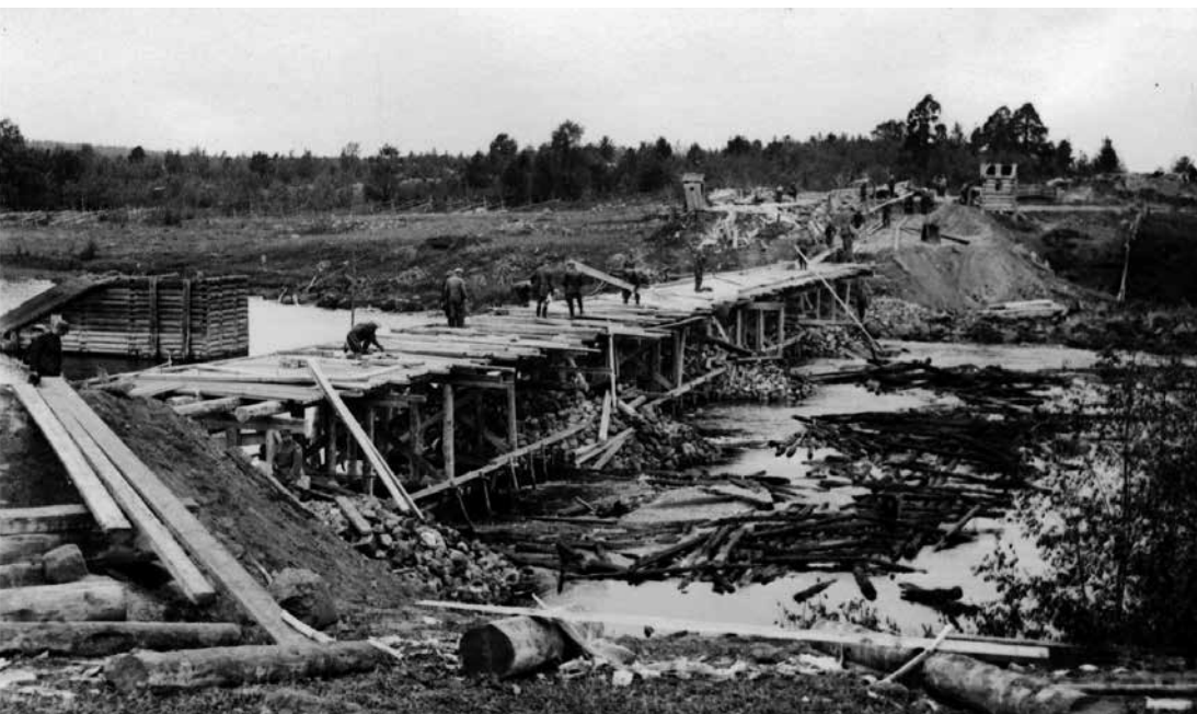
■ Linnoitusrakennuspataljoona 461 Salmenniskan–Sänkäjoen autosillan kantta naulaamassa. Kuva: Museo Militaria.
