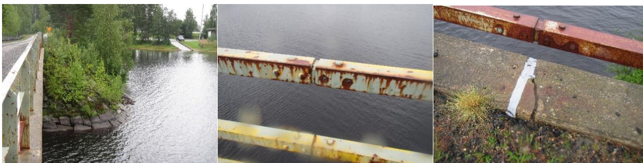
Kuvat: Kasvillisuudesta puhdistettava keila. Kunnostettava kaide. Korjattava reunapalkin liikuntasauva.
