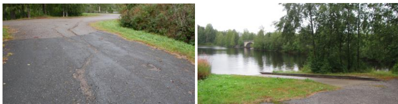
Kuvat: Pysäköintialueen kulunut päällyste. Venuiska.
