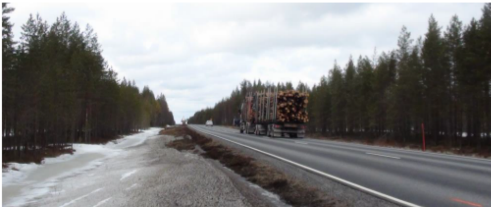
Kuva 74 Karstulan kohde 25.4.2017 kuvattuna Percoasemalta pienenevän paalulukeman suuntaan. Tierakenteen paksuus noin 1,0 m.
