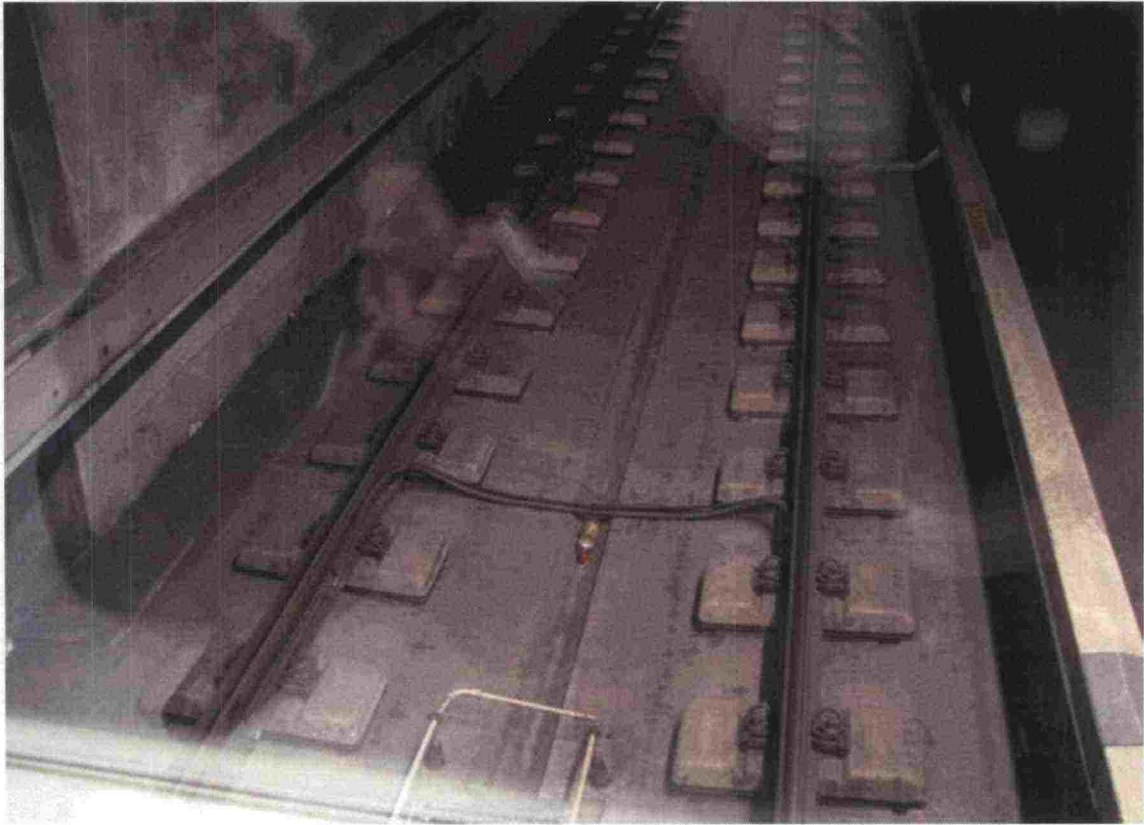
Kuva 13. Lähikuva Sonneville LVT -kiintoraiteesta.
