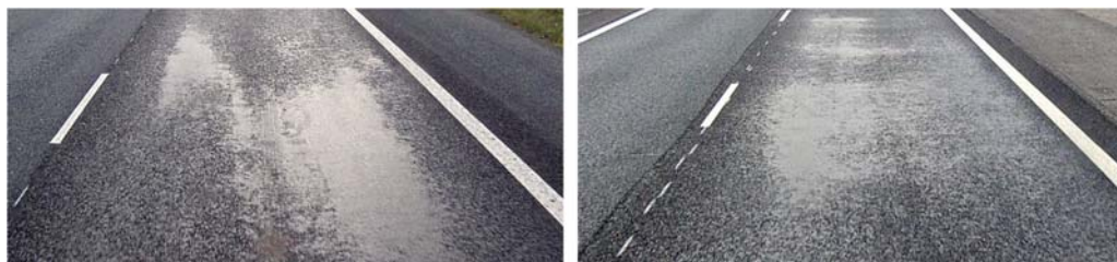
Kuva 1. Esimerkki bitumin pintaan noususta (Destia Oy 2016).
