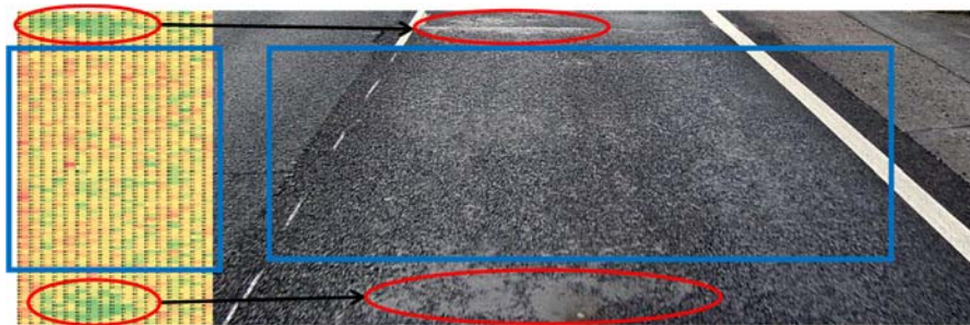
Kuva 31. Esimerkki mittausmenetelmällä B saaduista makrokarkeuksista kohdissa, joissa on selvästi purkautunutta päällystettä (sininen alue) ja bitumia nousut päällysteen pintaan (punaiset alueet) (Destia Oy 2016).
