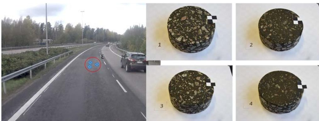
Kuva 12. Näyte E valtatiellä 1 tieosalla 7 suunnassa 1 kaistalla 2 kohdassa 3610 m. Kaistan keskeltä 30 cm oikeaan, bitumia noussut pintaan lammikoksi.
