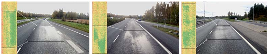
Kuva 27. Esimerkkejä mittausmenetelmällä B saaduista makrokarkeuksista kohdissa, joissa on selvästi bitumia nousut päällysteen pintaan (Destia Oy 2016).
