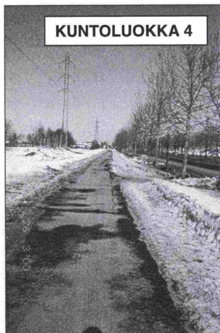
Kuva 43. Auringon sulattama paljas kevyen liikenteen väylä (kohde 9).
