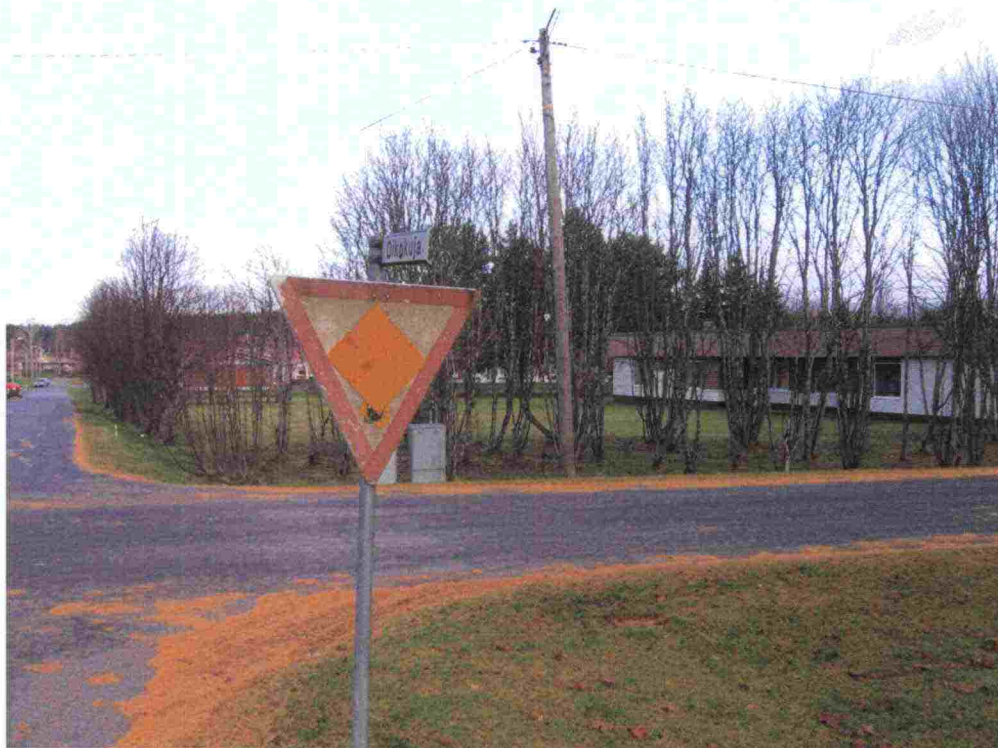
Kuva 24. Satamatiellä Pihlajatien ja Oikokujan liittymässä väistämivelvollisuusmerkit ovat huonokuntoisia.
