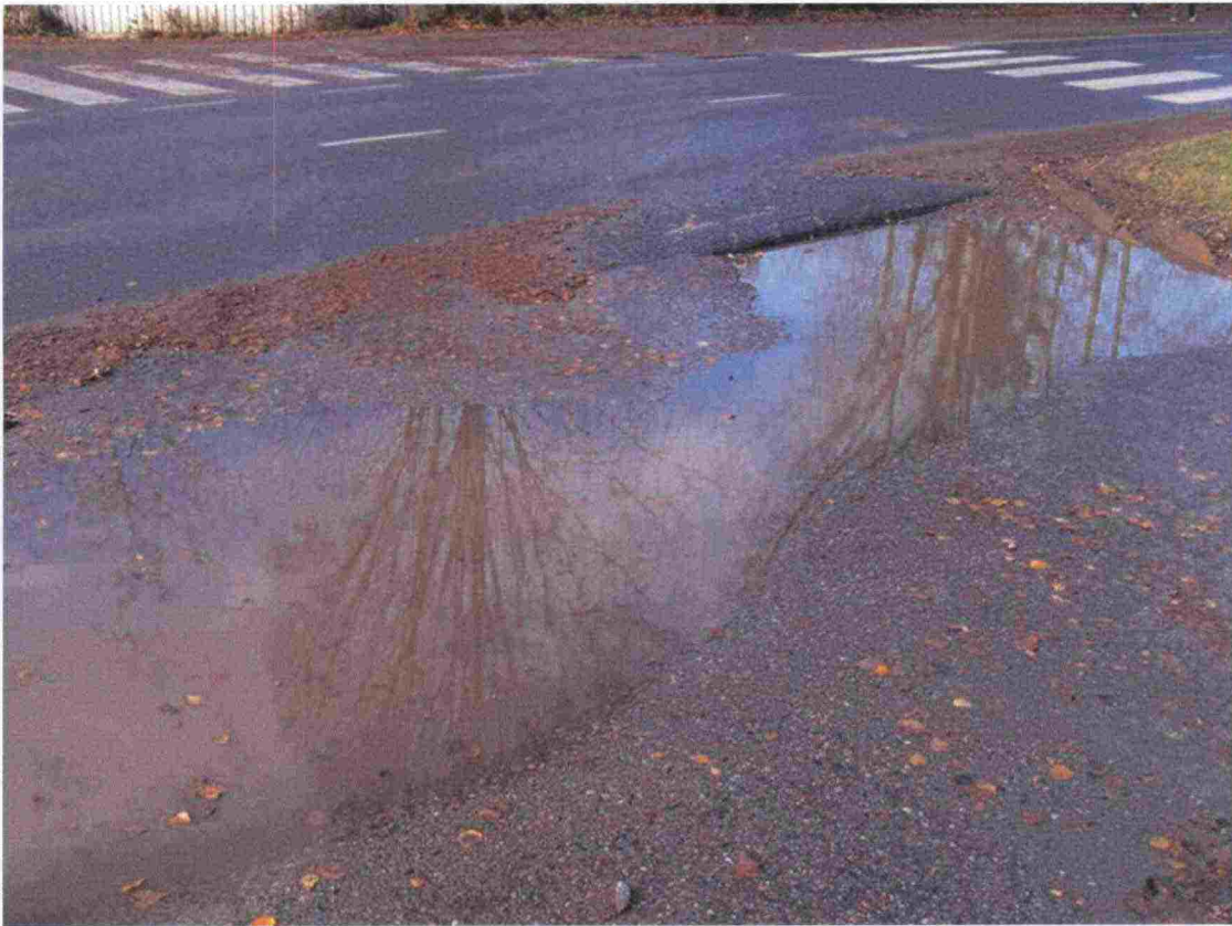
Vaunupojat-liikkeen tonttiliittymässä on paha painumavaurio.
