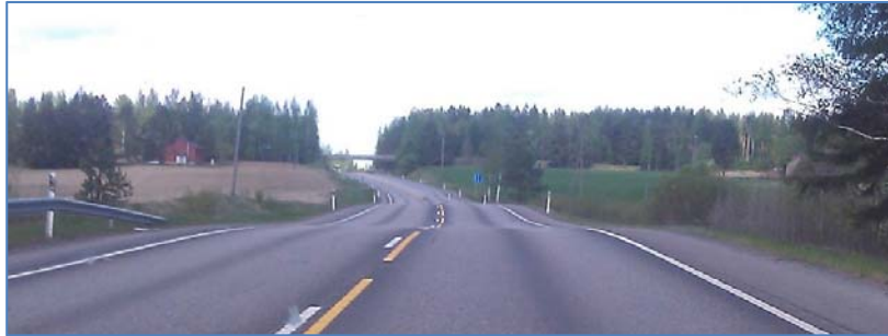
Kuva 31. Vahijärven painumakohta kantatiellä 55 tieosalla 3 kohdassa 3100.
