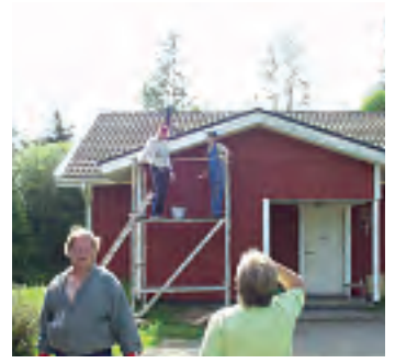
Kerkonkosken vuokratilat maalattiin myös työkauden aikana. Maalaustyön edistymistä seuraa projektipäällikkö Pirjo Karinen.
