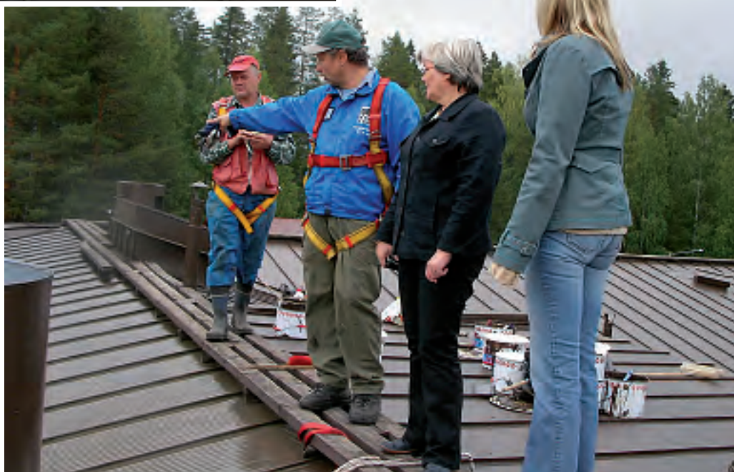
Tuusniemen viraston katon vanhat maalit poistettiin kemiallisesti ja katto maalattiin uudelleen. Korkealla katolla turvavälineet olivat ensiarvoisen tärkeitä. Projektipäällikkö Pirjo Karinen ja projektsihteeri Elina Väisänen tutustumassa maalaustöiden etenemiseen.
