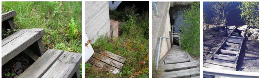
Kuva 49. Kunnostustarpeessa olevia siltapaikan portaita.
