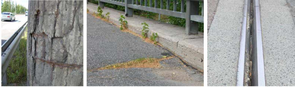
Kuva 2. Puhdistuksen ja puhtaanapidon laiminlyönnin seurauksia (suolattavan maantien ylittävän sillan välituki rapautunut vakavasti, kasvillisuutta päällysteen saumoissa, liikuntasauaman kumiprofiili rikkoutunut ja vesitiiveys menetetty).
