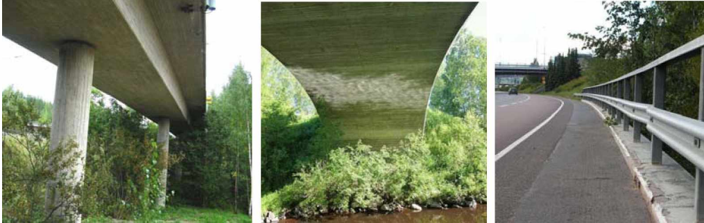
Kuva 25. Sillan alla kasvavaa ja sillalle tunkeutuvaa vesakkoa ja puustoa.
