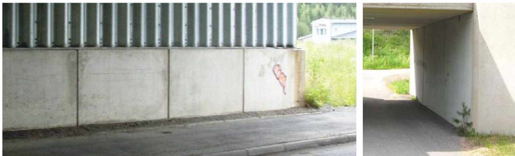
Kuva 6. Maa-aineksia ja kasvillisuutta poistamatta etumuurin edestä.
