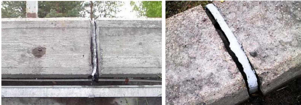
Kuva 37. Hoitourakoitsijan vastuulla olevia kunnostettavia reunapalkin liikuntasäumäjä.
