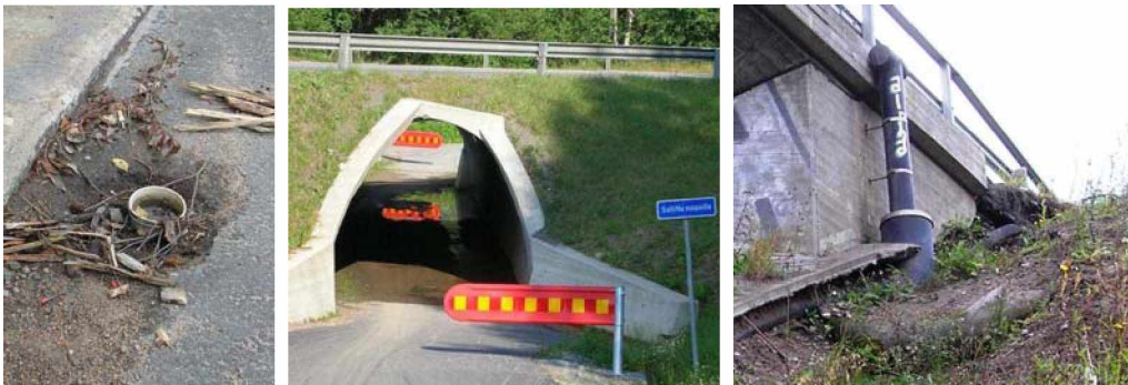
Kuva 1. Tyypillisiä sillan ja siltapaikan kuivatusongelmia hoidon laiminlyönnin vuoksi (syöksytorvi tukossa, alikulkukäytävän hulevesikaivo tukossa ja reunapalteiden aiheuttama eroosiovaurio keilassa).
