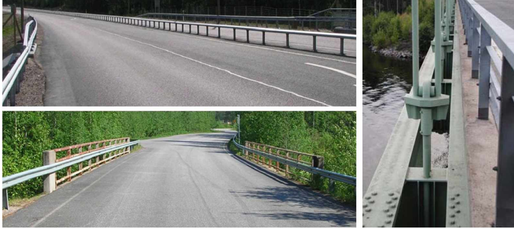
Kuva 4. Kansi ja tulopenkere ovat puhtaat hiekasta, kasvillisuudesta ja irtoaineksesta, samoin Langer-palkkisillan ajoradan ylä- ja ulkopuoliset päällysrakenteen osat.
