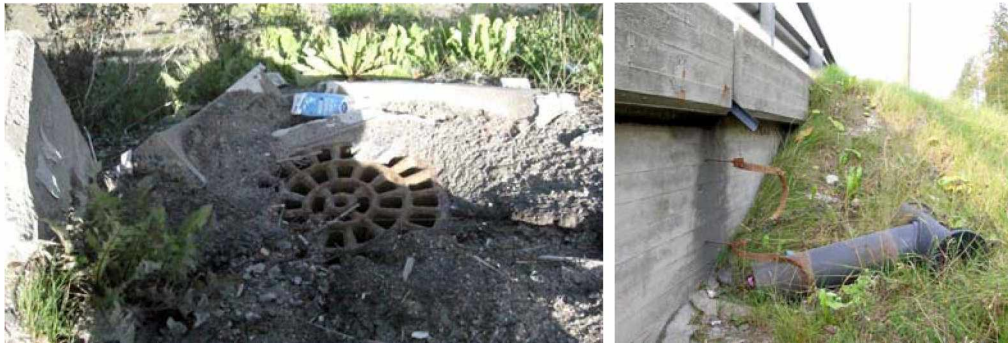
Kuva 46. Tyypillisiä siltapaikan kuivatuslaitteiden vaurioita, joiden korjaaminen kuuluu hoitourakoitsijalle.
