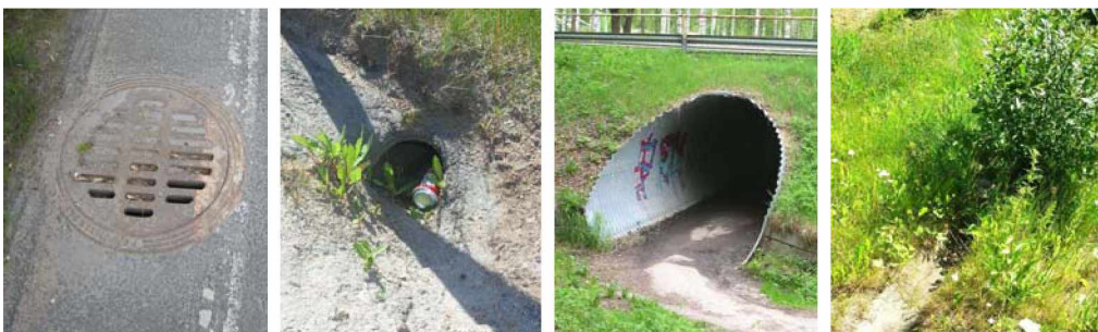
Kuva 23. Tyypillisiä siltapaikan kuivatuslaitteiden puhdistuksen laiminlyöntejä.
