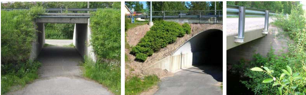
Kuva 26. Alikulkukäytävien siipimuurien edustalle kertynyt kasvillisuus ja hiekka estää veden pääsyn hulevesikaivoon, vesakko rehottaa vesistöisillan siipimuurin edessä.
