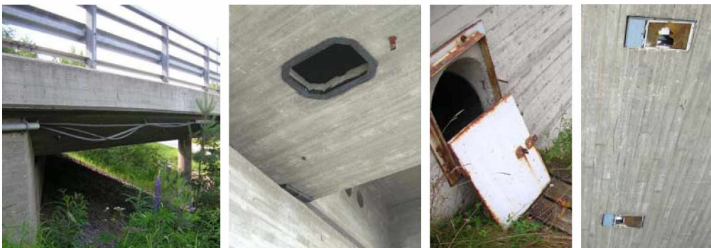
Kuva 51. Tilajalle ilmoitettavia sillan varusteiden vaurioita.
