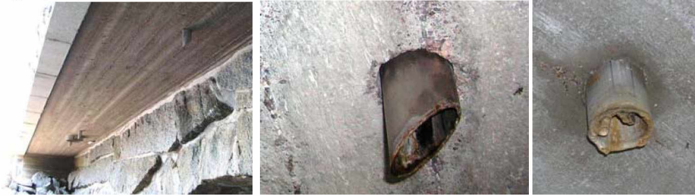
Kuva 15. Tippuputket ovat kunnossa. Tippuputkien huolto kuuluu ylläpitoon, mutta hoitourakoitsijan on ilmoitettava tilaajalle havaitsemistaan tukoksista tai muista vaurioista sekä poistettava jääpuikot väylän yläpuolisista tippuputkista.
