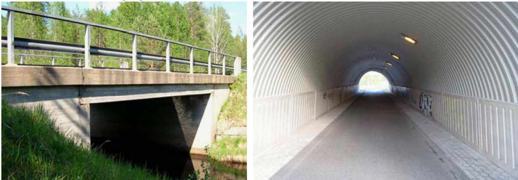
Kuva 1. Maatuella ei ole kasvillisuutta eikä maa-aineksia. Etumuuri ja sen kivetty edusta alikulkukäytävässä ovat puhtaat kasvillisuudesta, hiekasta ja irtomaineista. Töhröjen poistosta sovitaan erikseen urakkakohtaisesti.
