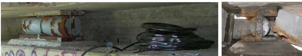
Kuva 9. Laakeritasolle jätettyjä tai pudonneita sillan varusteita.
