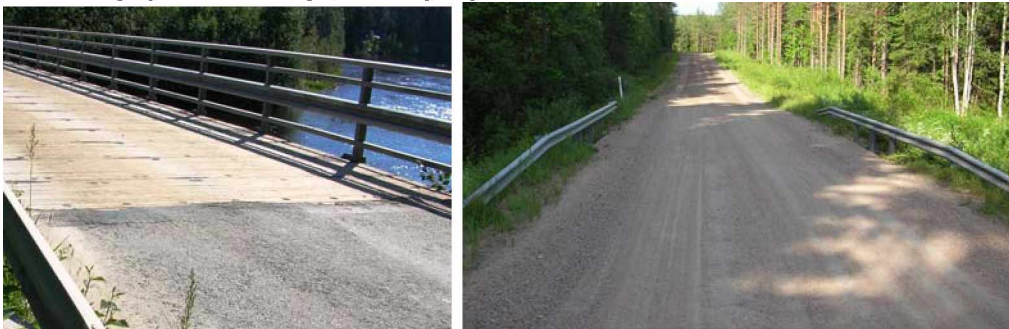
Kuva 10. Ei liikennettä haittaavaa kynnystä sillan ja penkereen rajalla.
