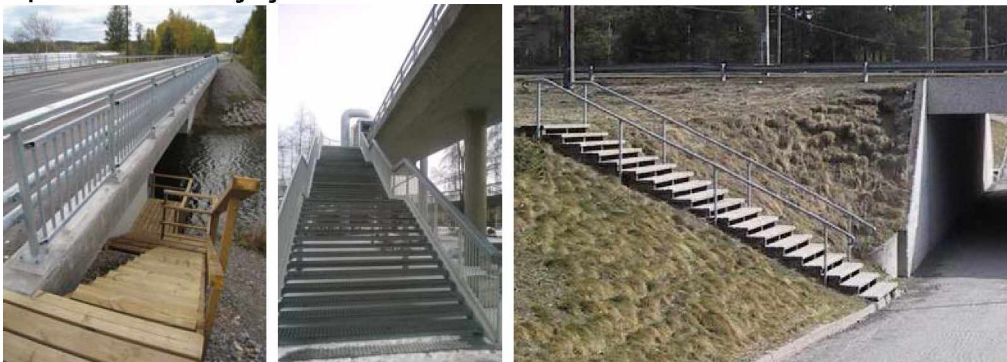
Kuva 24. Portaat kaiteineen ovat kunnossa ja hyvin hoidettu, turvalliset käyttää. Ei päällekkäystä kasvillisuutta eikä askelma- tai kaidevaurioita.
