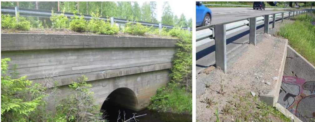
Kuva 14. Sillan reunapalkin ja ajoradan välissä voi olla leveäkin päällystämätön alue, jonka purkautumista on varottava reunapalkin pesun yhteydessä.
