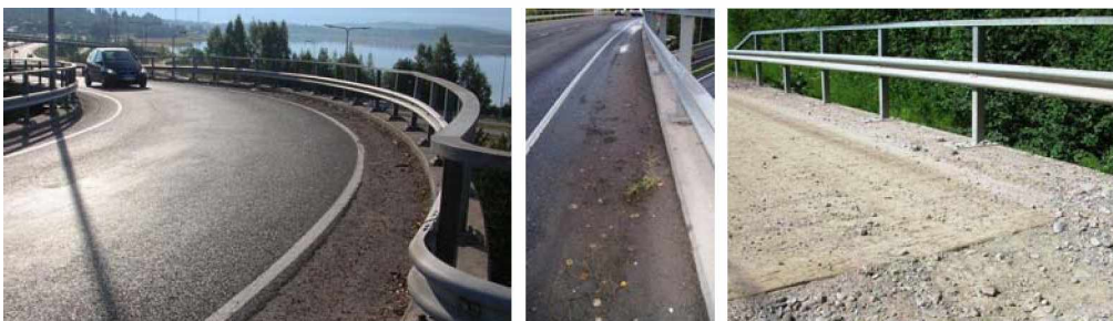
Kuva 10. Hiekkaa, soraa ja muita epäpuhtauksia sillan kannella.
