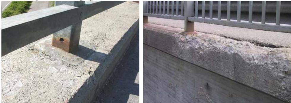
Kuva 6. Reunapalkit ovat hoidon suhteen kunnossa. Rapautuneen reunapalkin kunnostus kuuluu ylläpitoon.
