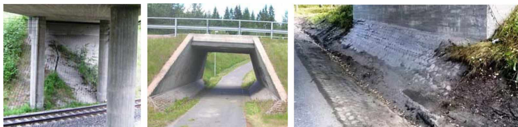
Kuva 24. Etuluiskan kiveys siistimättä tai siistitty huolimattomasti.
