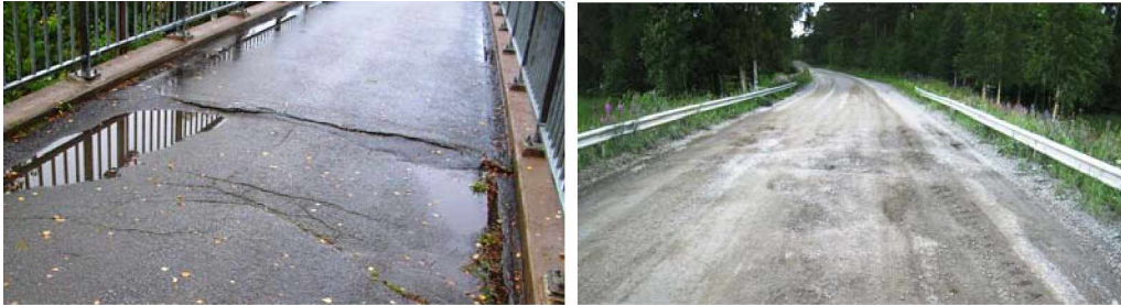
Kuva 34. Välittömästi korjattavia päällyste- tai kulutuskerrosvaurioita.
