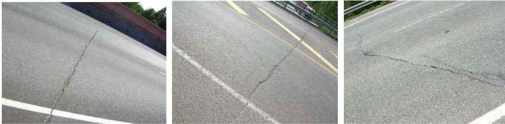
Kuva 40. Hoitourakoitsijan vastuulla olevia sillan pään suljettavia halkeamia.
