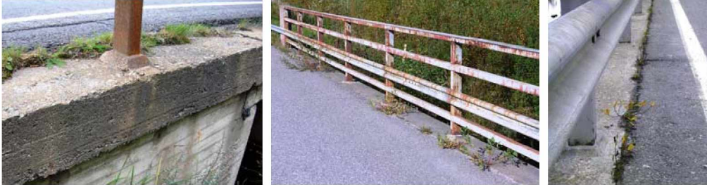
Kuva 39. Kunnostettavia reunapalkin ja päällysteen välisiä saumoja.
