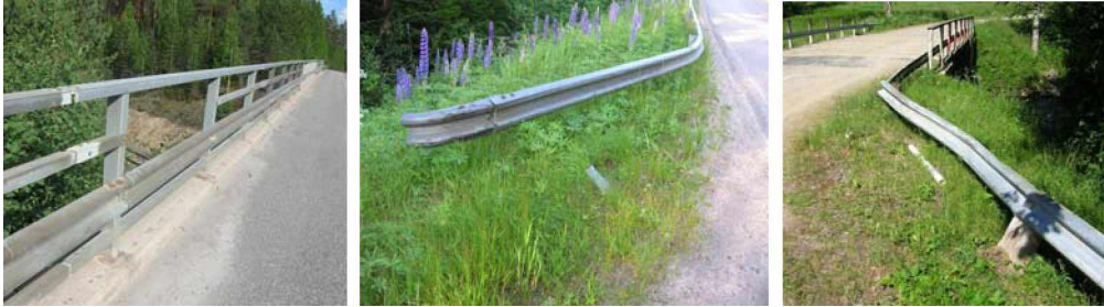
Kuva 50. Jatkuvalla tarkkailulla havaittuja korjattavia kaidevaurioita.
