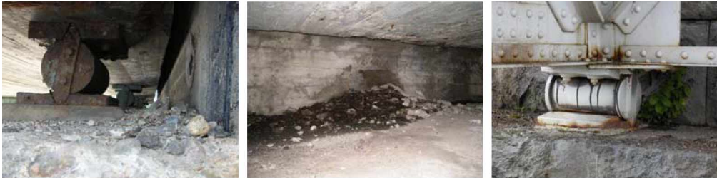
Kuva 8. Sillan laakeritasot puhdistamatta irtoaineksesta ja kasvillisuudesta.
