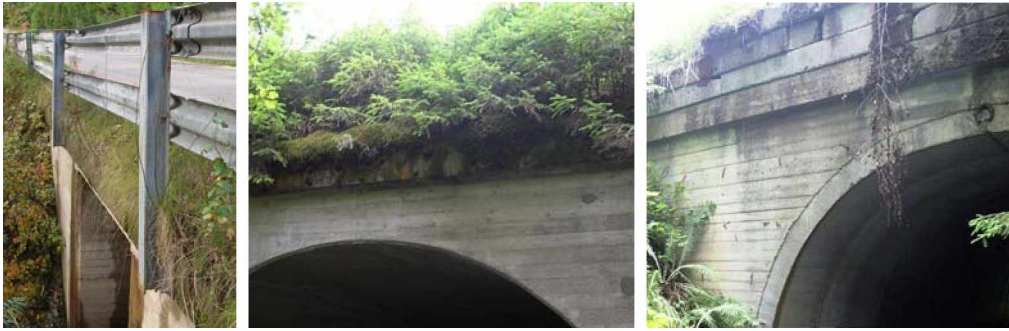
Kuva 13. Puhdistamattomia sorateiden reunapalkkeja ja reunapalkin korotuksia.
