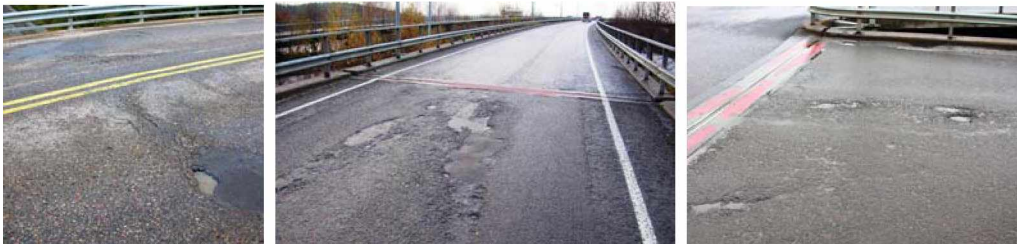
Kuva 35. Yhden viikon toimenpideajassa paikattavia päällystevaurioita.
