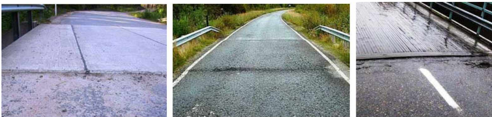
Kuva 41. Hoitourakoitsijan vastuulla olevia sillan pään korjattavia kynnysmuodostumia.
