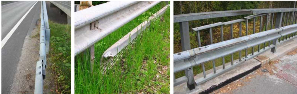
Kuva 42. Irronneita ja löystyneitä sillan- ja pengerkaiteiden kiinnityksiä.
