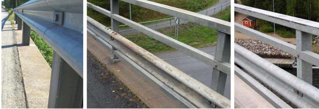
Kuva 11. Kaiteet ovat hoidon näkökulmasta (puhtaus, kiinnitykset) kunnossa. Väärä kaidetyyppi, suojaverkon puute ja johteiden ruostuminen ovat ylläpidon asioita.
