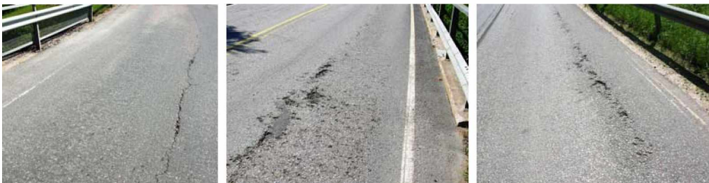
Kuva 36. Syyskuun loppuun mennessä paikattavia päällystevaurioita.
