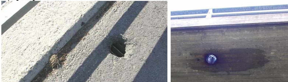
Kuva 14. Syöksytorvet ovat puhtaat eli hoidon näkökulmasta kunnossa. Liian syvällä oleva torven yläpää, liian lyhyt putki sekä vesivuoto ovat ylläpidon asioita.
