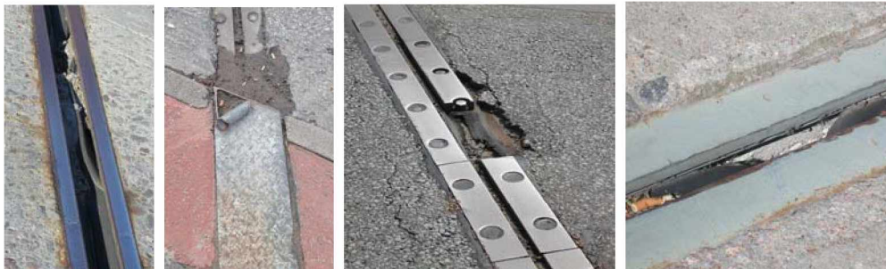
Kuva 21. Liikuntasaumalaitteet puhdistuksen lisäksi korjauksen tarpeessa. Liikuntasaumalaitteen korjaus ei kuulu hoitourakoitsijalle, mutta ilmoitus vauriosta tilaajalle kuuluu.
