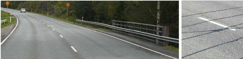
Kuva 9. Vasemmalla ei halkeamaa ole syntynyt, oikealla sillan pään poikkihalkeamaongelma on ratkaistu usealla kapealla saumalla.
