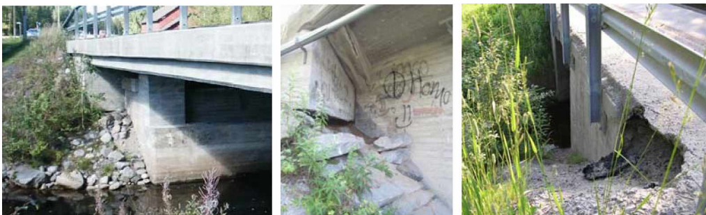
Kuva 48. Hoitourakoitsijan vastuulle kuuluvia keilavaurioita (alle 2 m 2 :n suuruisia purkautumia ja poistamatta jätettyjen reunapalteiden aikaansaama eroosiovaurio).
