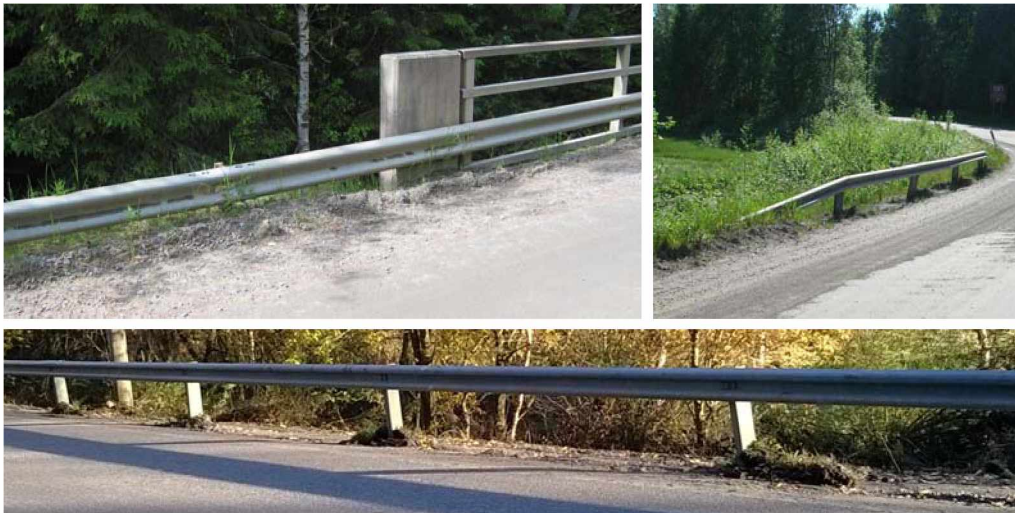
Kuva 30. Palteet poistamatta tai poistettu huolimattomasti pengerkaitteiden alta.
