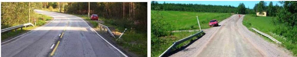
Kuva 45. Kunnostustoimenpiteitä vaativia reunapaaluja (vinossa tai puuttuu).
