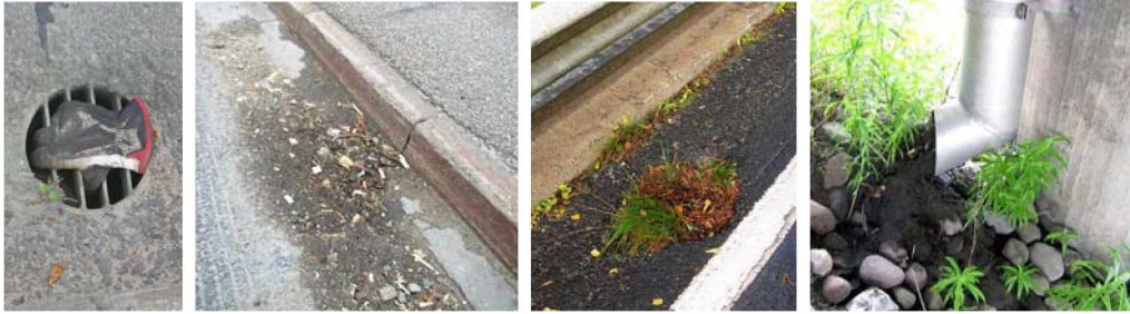
Kuva 22. Puhdistamattomia ja tukossa olevia syöksytorvia.
