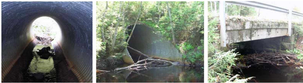
Kuva 28. Sillan alittava uoma raivaamatta.
