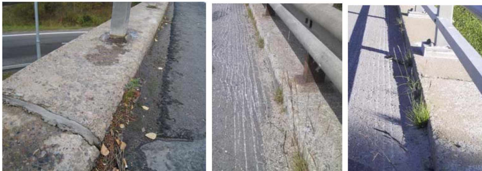
Kuva 17. Reunapalkin ja päällysteen välinen sauma jäänyt puhdistamatta.
