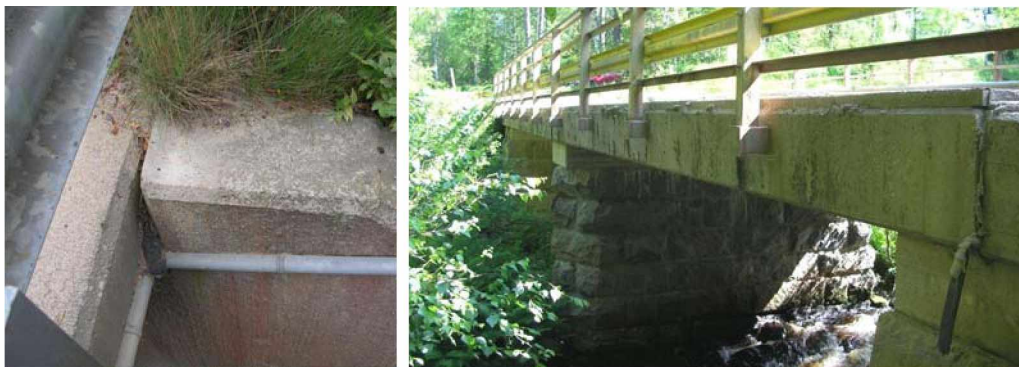
Kuva 38. Hoitourakoitsijan kunnostusvastuuseen kuuluvia elementtirakenteisten siltojen säumäjä maatuen ja kansielementin sekä peräkkäisten kansielementtien välillä.
