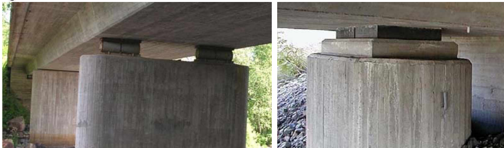
Kuva 13. Laakerit ovat kunnossa. Laakereiden suhteen hoitourakoitsijalla on vain velvollisuus ilmoittaa tilaajalle havaitsemistaan puutteista ja vaurioista.
