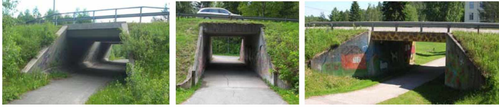
Kuva 5. Laattakehä- ja Tobi-alikulkukäytävien suolarasitukselle alttiita siipimuureja.
