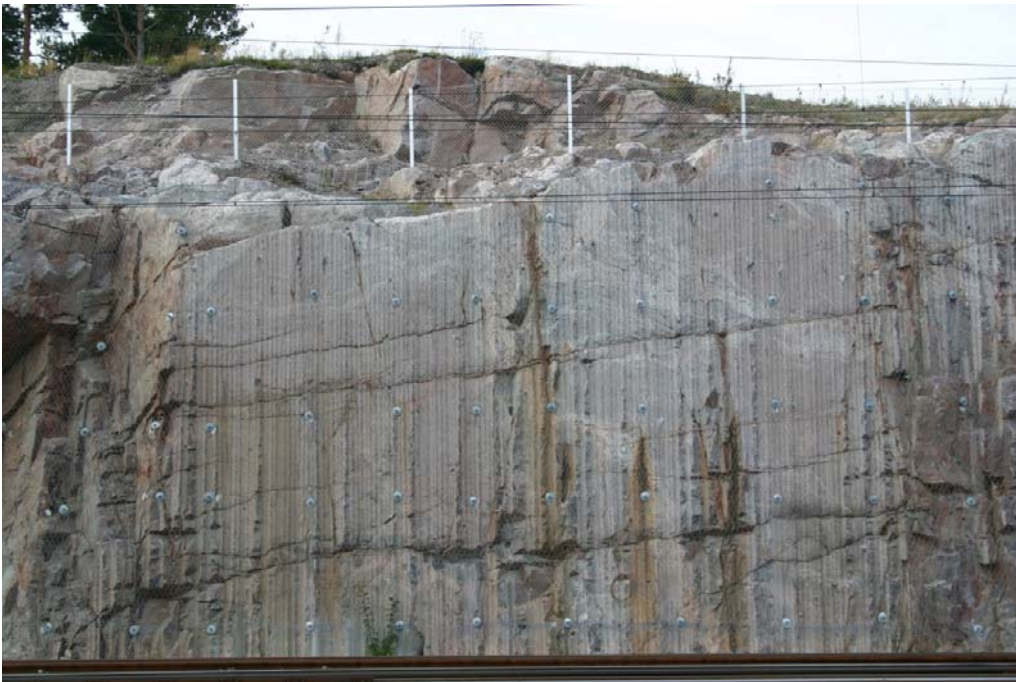
Kuva 11. Irtiporaamalla muodostettua kallioleikkausta Pasilan rautatieaseman pohjoispuolella. Leikkauseinämä on myös pultitettu ja verkotettu. Ku-vattu 2014.
