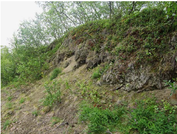
Kuva 152. Eroosiokohteen rinne on melko jyrkkä. Kuva: A. Kurkela.
