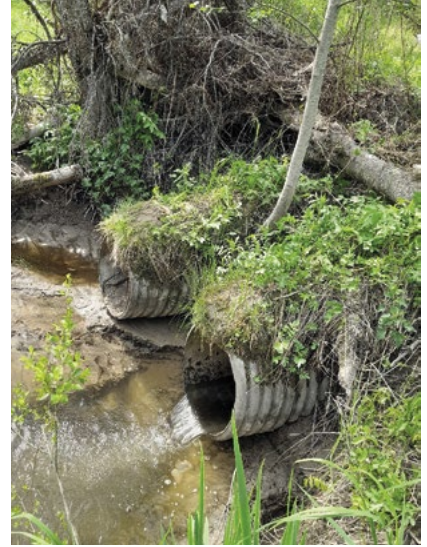
Suurin osa esteistä on tierumpuja, jotka on asennettu liian korkealle tai rummun alapuolinen purouma on syöpyntynyt. Tällöin rummun alapäähän voi muodostua putous, joka estää vesieliöiden nousun.
